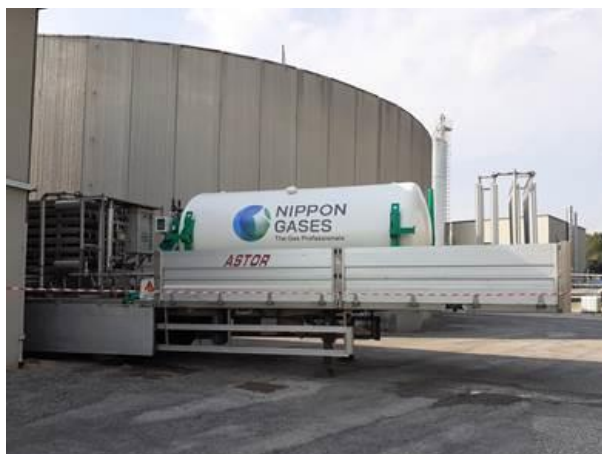
Figura 3-1: Depuratore "Città di Verona": immagine del digestore (sulla sinistra) e dell'impianto per la saturazione dell'aria con gas inerti (al centro).
