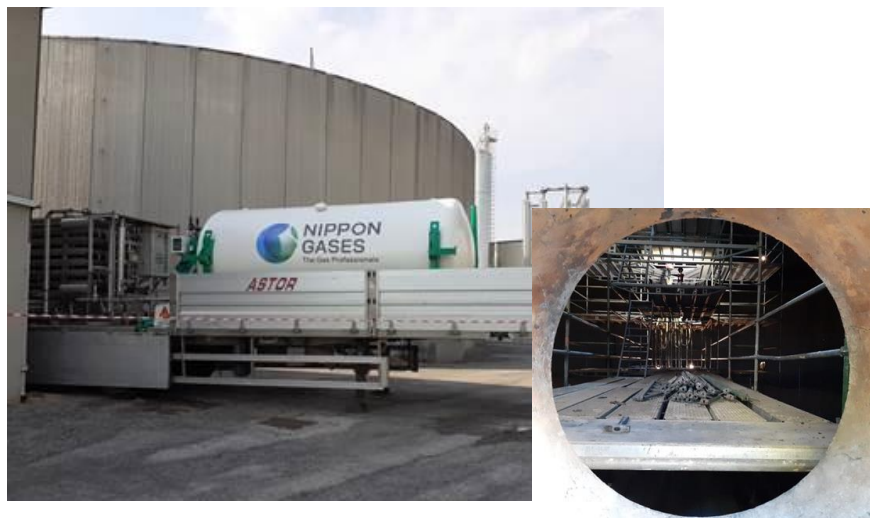
Figura 3-1: Depuratore "Città di Verona": immagine del digestore (sulla sinistra), dell'impianto per la saturazione dell'aria con gas inerti (al centro) e del passaggio creato per la manutenzione interna (a destra).
